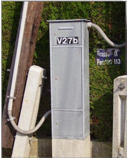
Stromversorgungs- und Steuerschrank Zugang Seitenweg 9
