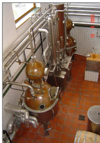
Obsthof Retter - Edelbrandanlage
